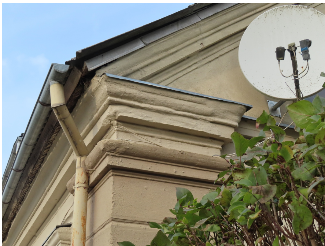
Ventspils_12_88130010002001 -dzega1 Sākotnējā dzega ēkas dienvidu stūrī. Zem esošā jumta seguma saglabājies sākotnējais skaidu zemsegums.
