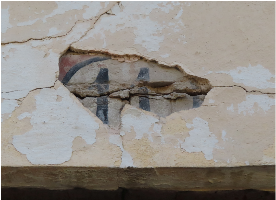
Ventspils_11_88130020019001_fragments1 Ēkas numurs sākotnēji krāsots uz ķieģeļu mūra. Apmetums hronoloģiski jaunāks, domājams, 1920.-1930.gadi.
