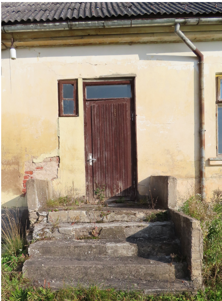
Ventspils_11_88130020019001_fragments2 1970.gados pārbūvēta sākotnējā durvju aila (sašaurināta). 20.gs. 2.puses mūra kāpnes, neatbilstošas.
