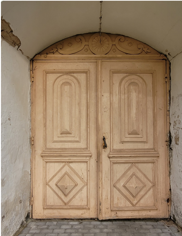
Ventspils_4_88130010096001 _durvis1 Baznīcas galvenās ieejas durvis. Vērtnes – 19.gs. 2.puse. Virs vērtņēm esošais dekors, iespējams, hronoloģiski senāks.
