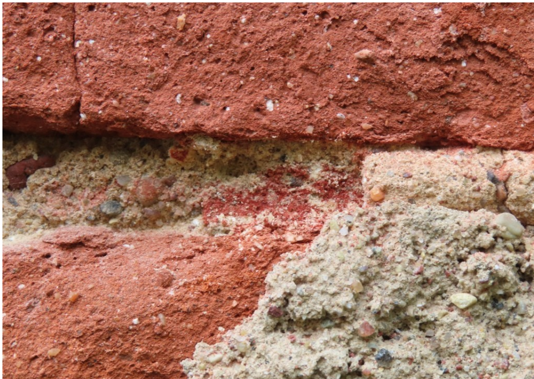
Talsu_17_88130040010001_fragments1 Ķieģeļu mūra fragments ar sākotnējo krāsojumu zem reljefi veidotas šuves.
