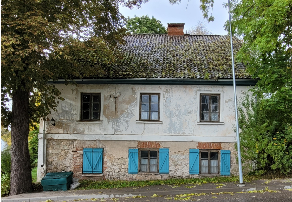
Talsu_13_88130010054001_fasade1 Skats uz ēku no dienvidaustrumiem. Ēkas 1.stāvā zudis sākotnējais apmetums.
