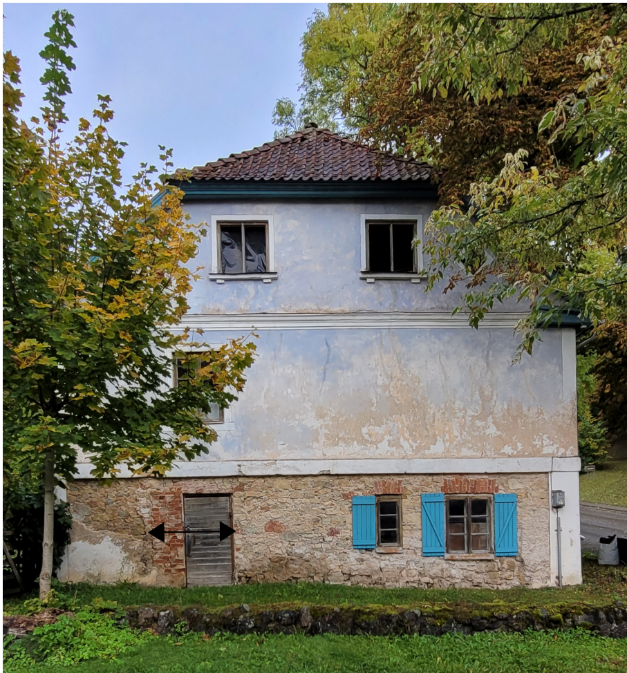
Talsu_13_88130010054001_fasade2 Skats uz ēku no dienvidrietumiem. Fasādes kreisajā pusē vēsturiski sašaurināta divvērtņu aila.
