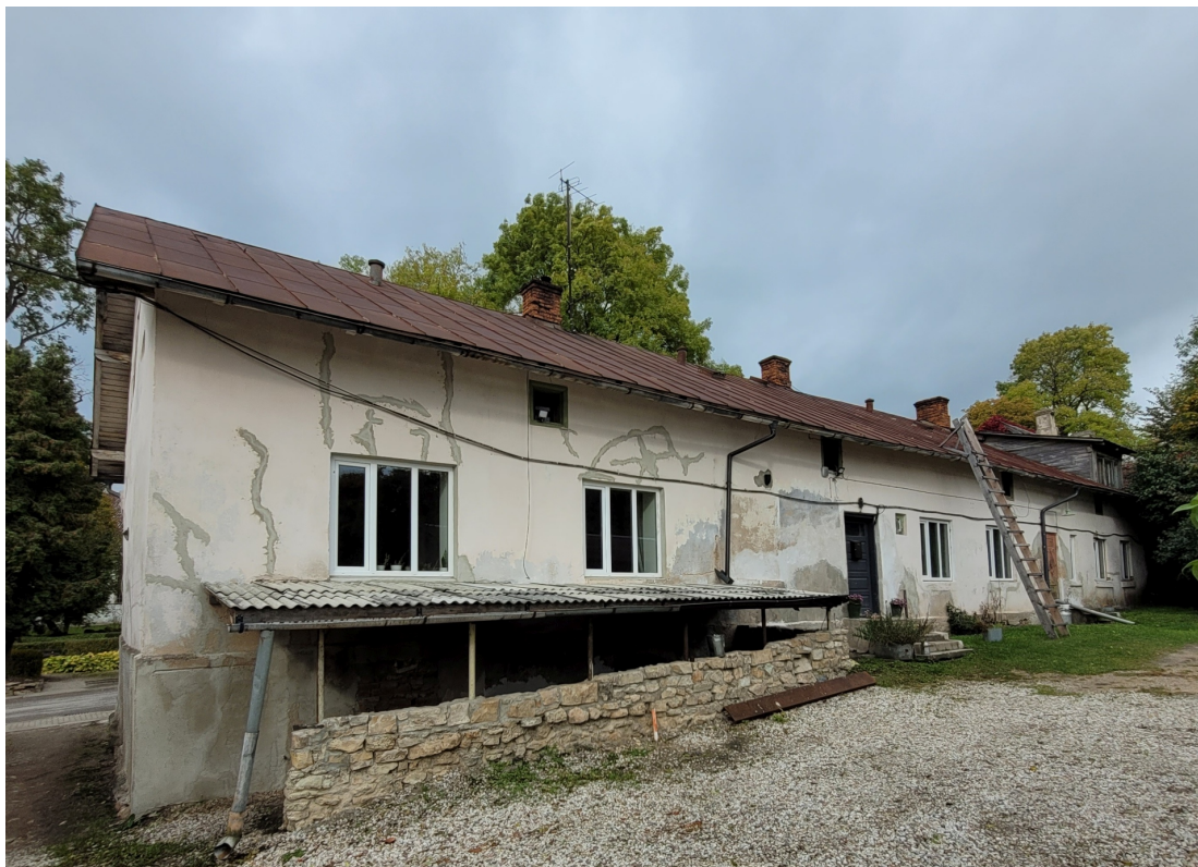
Talsu_10_88130010057001_fasade3 Skats uz ēku no dienvidaustrumiem. Pašreizējās pagraba noejas vietā vēsturiski bijusi piebūve.
