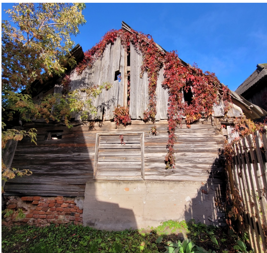
Talsu_4_88130010059004_fasade2 Skats uz ēku no dienvidaustrumiem. Centrā sekundāri aizbūvēta aila.
