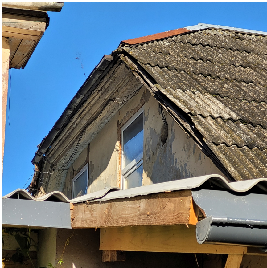
Talsu_4_88130010059001_fragments1 Skats uz ēkas dienvidrietumu fasādes zelmīni. Saglabājusies sākotnējā dēļu dzega.
