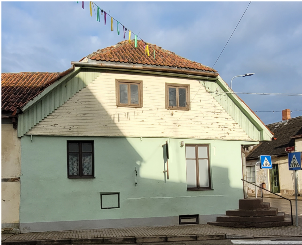
Talsu_1_7_88130010053001_fasade4 Skats uz ēkas hronoloģiski vecākā apjoma gala fasādi no dienvidrietumiem. Vēsturiskai ēkai neatbilstošs zelmaņa apšuvums (vēsturiski bijis apmetuma)
