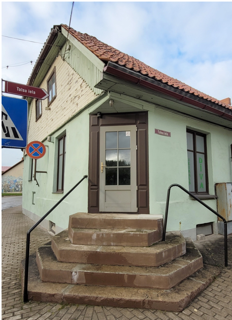
Talsu_1_7_88130010053001_fasade3 Skats uz ēkas dienvidu stūri no Talsu un Ventspils ielas krustojuma. Vēsturiskam neatbilstošs ieejas durvju risinājums (vēsturiski divvērtņu durvis). Neatbilstoši pakāpieni.
