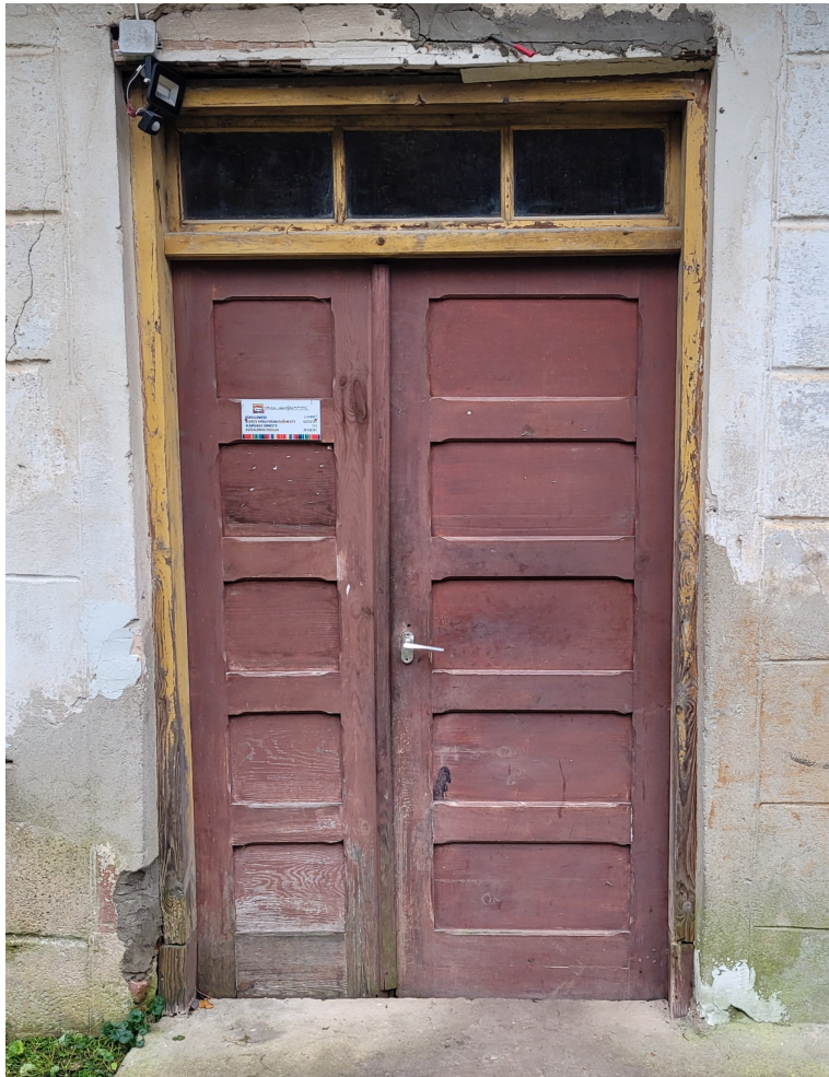
Riigas_29_88130040070001 _durvis1 1960.gadu durvju vērtnes sākotnējā aplodā. Saglabājies sākotnējais virslogs. 1 un 1/2 vērtņu dalījums ēkai nepiemērots.
