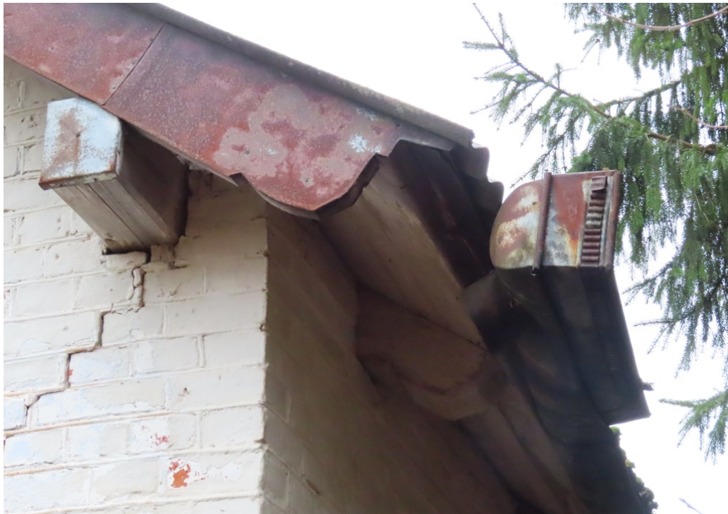
Riigas_22A_88130040068003_fragments2 Pamatapjoma ziemeļu stūris. Saglabājušies sākotnējie jumta konstrukcijas elementi un teknes savācējkārbā.
