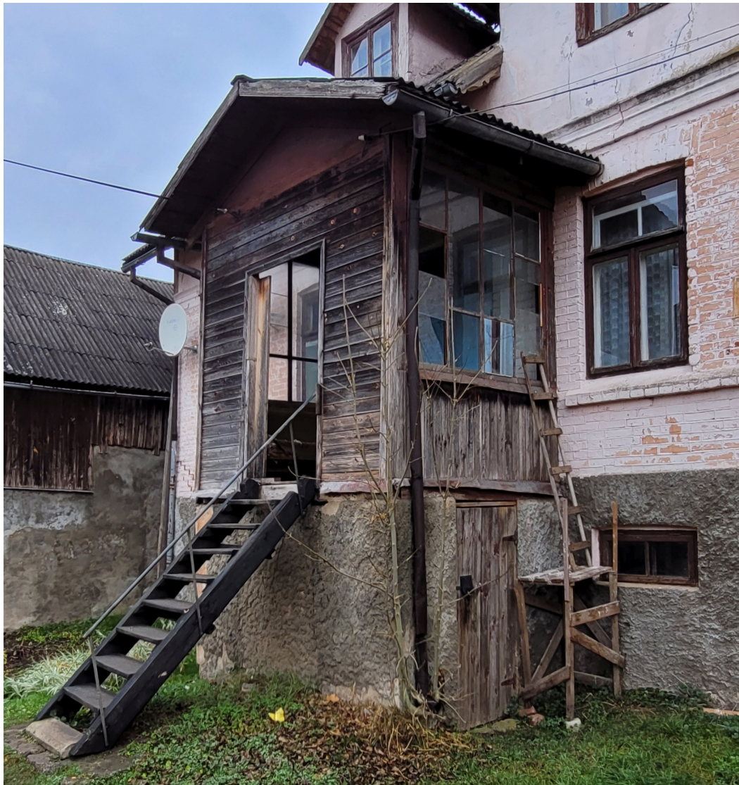
Riigas_21_88130040001001_fasade2 Skats uz rietumu puses ieejas izbūvi no dienvidaustrumiem. Koka daļa datējama ar 1950. - 1960.gadiem, realizācija nav atbilstoša sākotnējam risinājumam.
