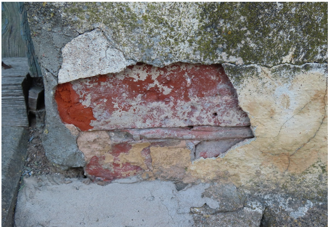
Riigas_15_88130040004001_fragments2 1.stāva sienas fragments ar atsegtu sākotnējo apdari – eksponētu, krāsotu ķieģeļu mūri.
