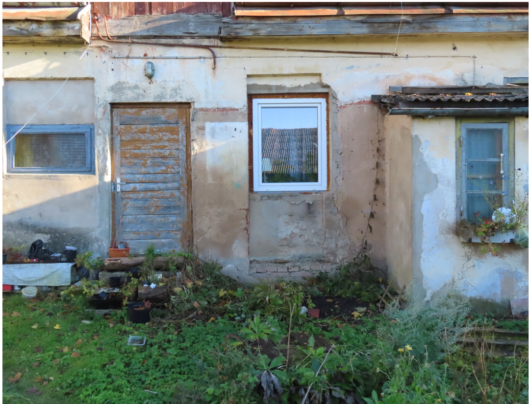
Riigas_13_88130040012001_fasāde8 Būtiski pārbūvēts ziemeļrietumu fasādes vidējās daļas fragments – likvidēta durvju aila un logs, demontēta vēsturiska piebūve (saglabājies jumta nospiedums).
