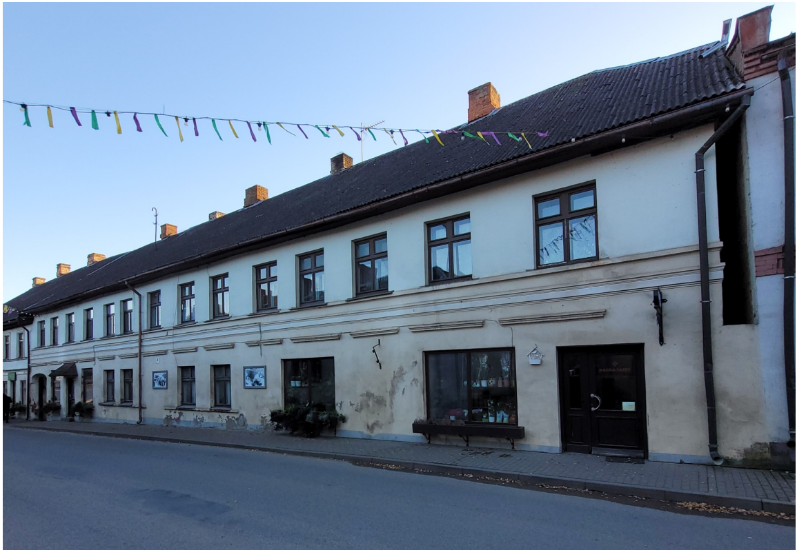
Riigas_8_1_88130020128001_fasāde1 Skats uz ēku no ziemeļiem. Fasādē 1.stāvā būtiski mainīts ailojums.
