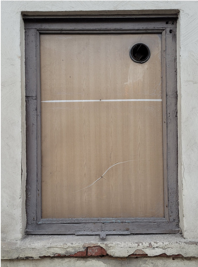
Riigas_8_88130020128001_logs1 Sākotnēja loga aploda, kam izzāgēts šķērsis. Zudusi ruļļveida žalūzija, saglabājusies tās metāla apakšējā daļa.
