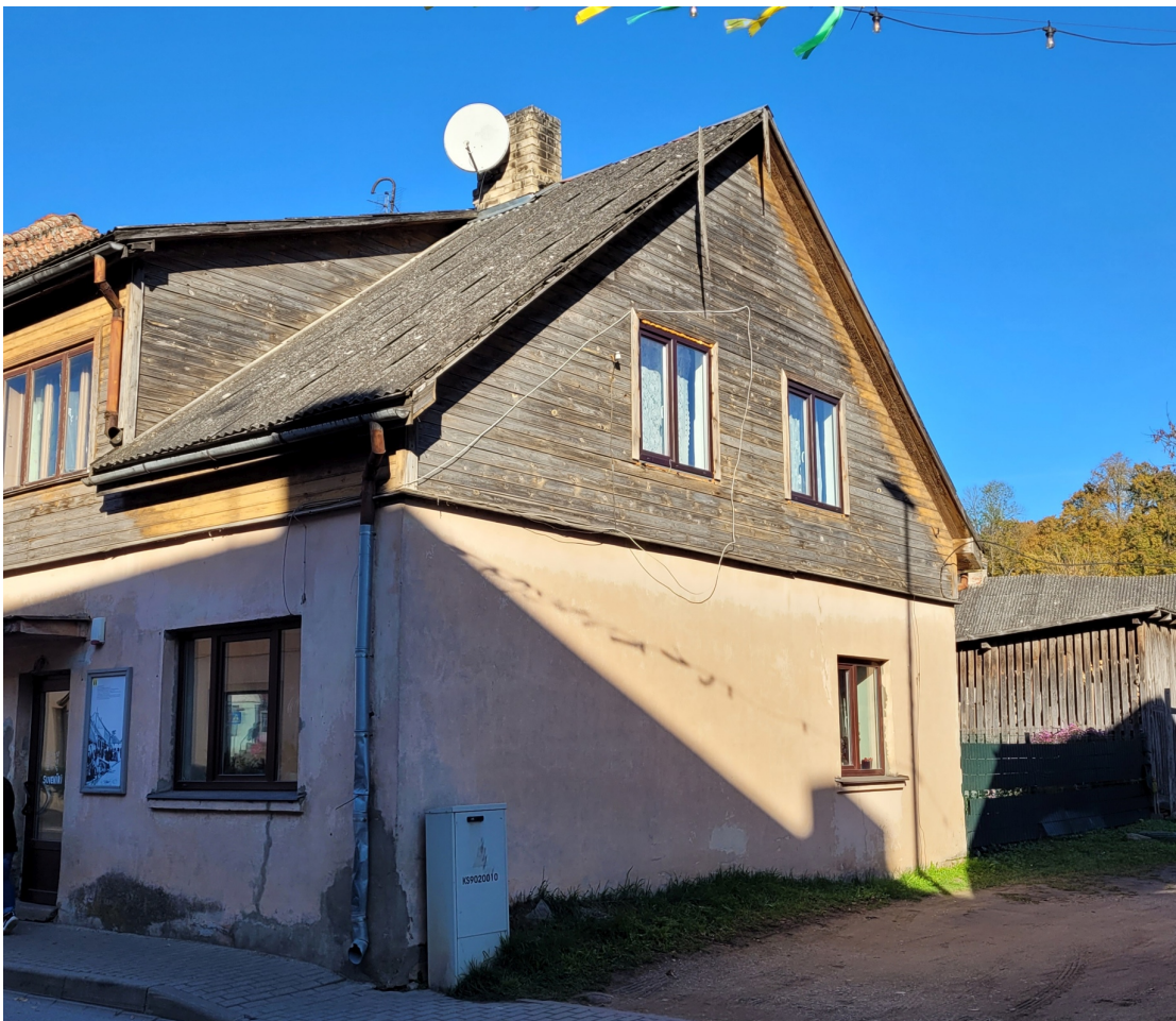
Riigas_3_5_88130010004002_fasade2 Skats uz ēku no dienvidiem. Pārbūvēts ēkas jumts, likvidēts nošļaupums.
