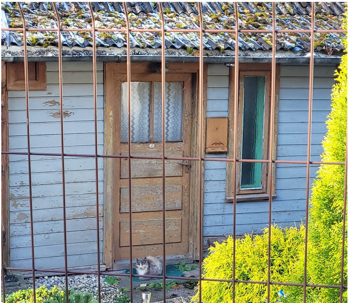
Pilskalna_9_88130040062001_fasade4 Skats uz 20.gs. 60.gadu piebūvi ar tai atbilstošiem būvgaldniecības izstrādājumiem ēkas ziemeļaustrumu fasādē.
