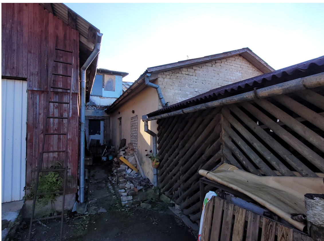
Pilskalna_5_88130010062001_fasade4 Skats uz ēku no ziemeļaustrumiem. Abas piebūves un sākotnējā apjoma jumta izbūve – 21.gs.
