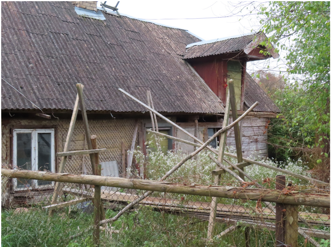
Kuldigas_6_88130020152001_fasade4 Skats uz ēkas pagalma fasādes dienvidrietumu pusi. Vēsturiska jumta izbūve ar pārkari pacelšanas mehānismam.
