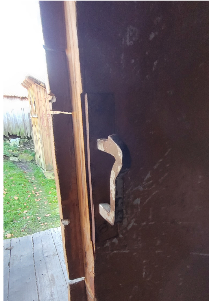
Kalna_2_88130040013001_durvis6 Sākotnēja atslēgas bultas ligzda.
