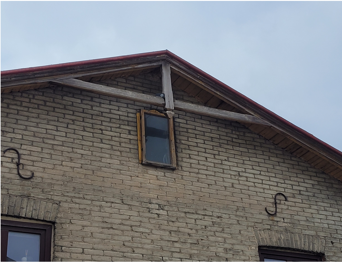
Abavas_1_88130020016005_fragments1 Ziemeļaustrumu fasādes zelminis ar sākotnējo jumtgailes dekoru un metāla enkuriem. Logaīla – 20.gs.2.puse.
