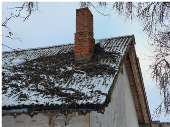
attēls 4.8.11 Piesārņojums uz jumta
