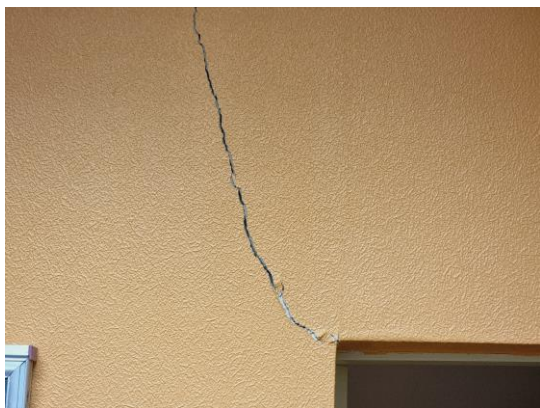
attēls 4.11.1 Trešais stāvs telpa nr.001-34. Plaisa ģipškartona sienā.
