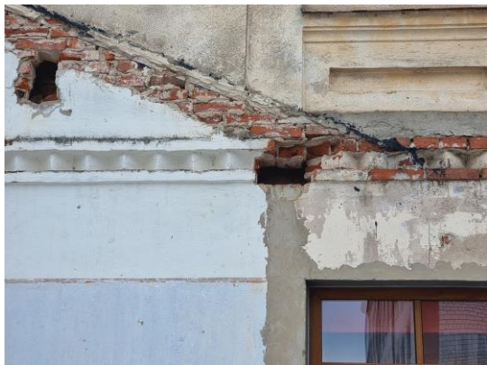
attēls 4.2.3 Austrumu puses ķieģeļu mūra caurumi
