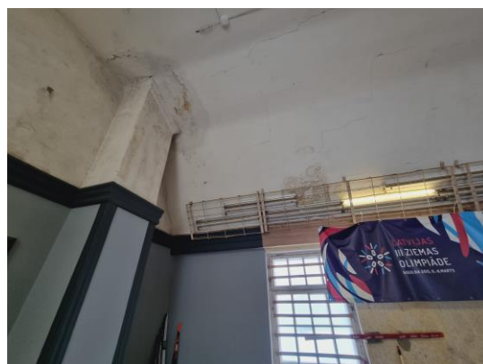
attēls 4.18.10 Ziemeļu korpusa telpu apdares bojājumi
