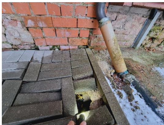
attēls 4.8.20 Noteksisstēmas bojājumu rezultātā izskalota pamatne
