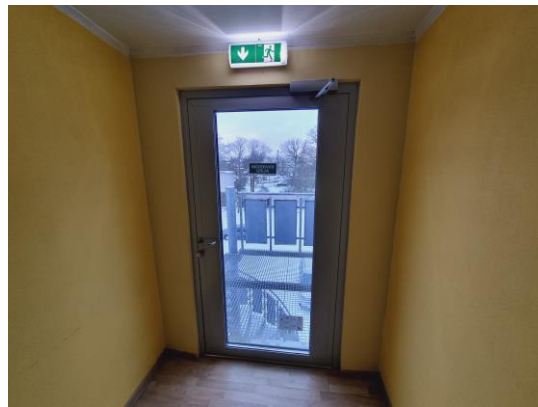
attēls 4.13.2 Trešā stāva evakuācijas durvis
