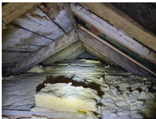
attēls 4.5.2 Siltumizolācija bēniņos
