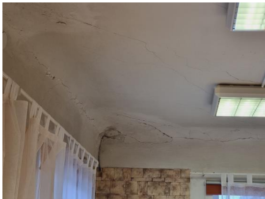
attēls 4.18.3 Griestu apdares bojājumi
