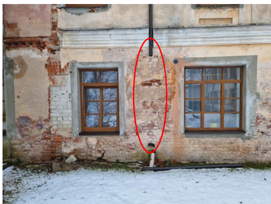
attēls 4.8.15 Notekai trūkst apakšējās posms
