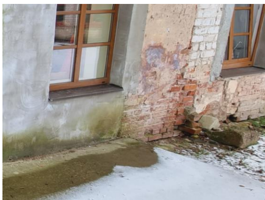
attēls 4.1.5. Pagalma puses cokola bojājumi
