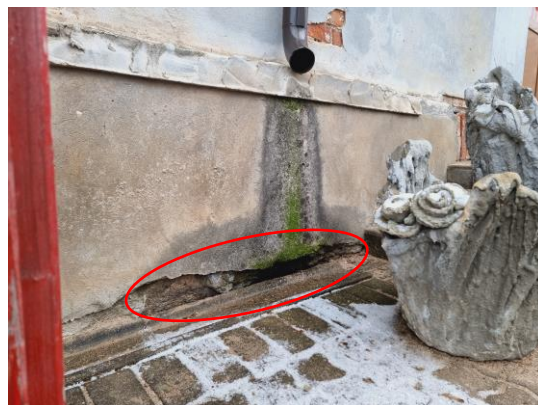
attēls 4.8.18 Notekūdeņi ieplūst pamatu daļā
