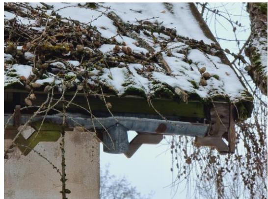
attēls 4.8.12 Piesārņojums uz jumta
