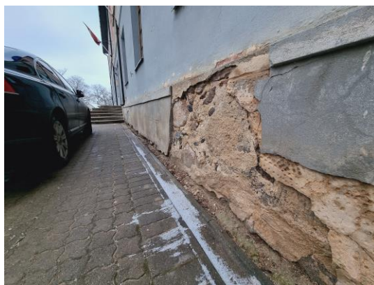
attēls 4.19.14 Cokola apmetuma bojājumi
