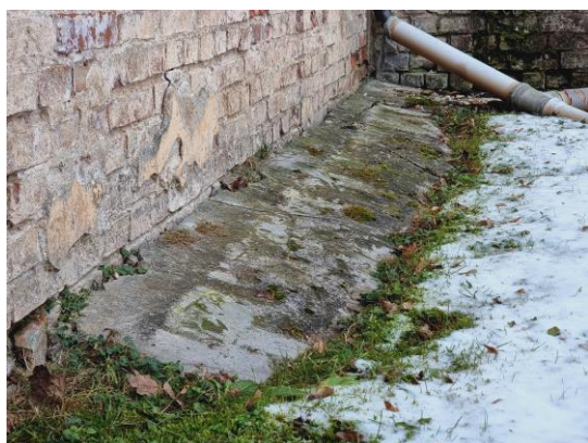
attēls 4.1.11 Atsevišķs betona apmales gabals pagalmā
