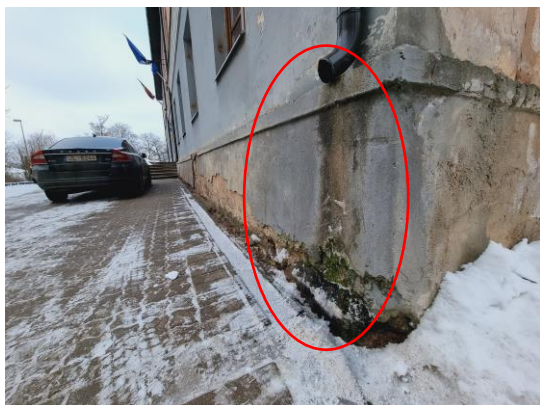
attēls 4.8.17 Notekūdeņi bojā cokola daļu
