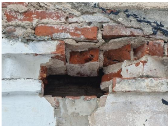
attēls 4.2.1 Austrumu puses ķieģeļu mūra caurumi
