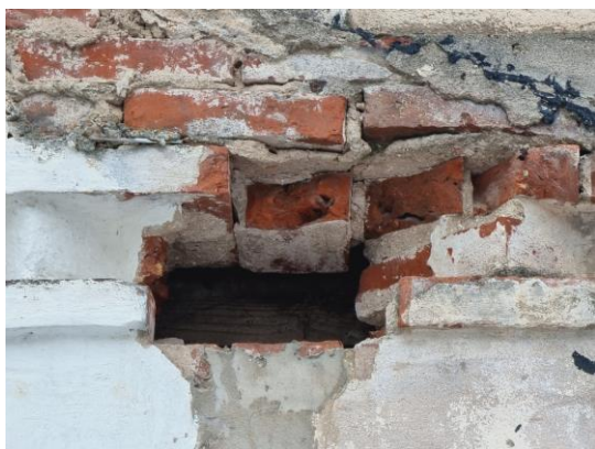
attēls 4.19.13 Cokola apmetuma bojājumi
