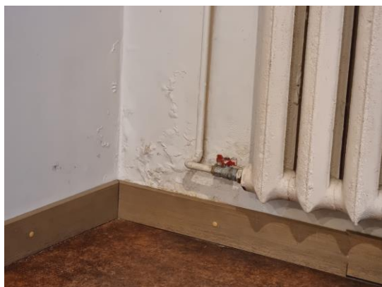
attēls 4.5.1 Mitruma radīti apdares bojājumi. Telpa 001-5
