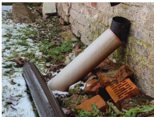
attēls 4.1.6. Pagalma puses cokola bojājumi
