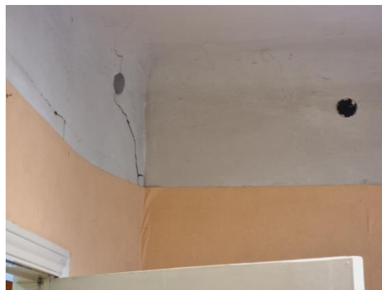
attēls 4.11.2 Otrais stāvs telpa nr.001-14. Plaisa mūra starpsienā
