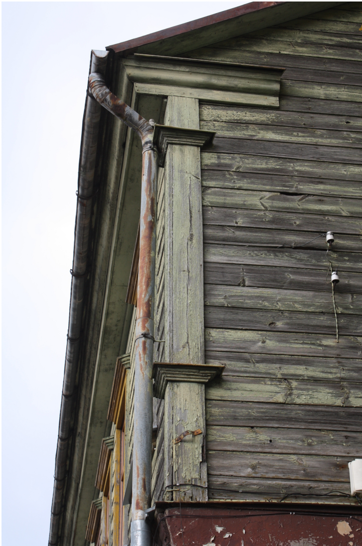
Rozju_3_88010130116001_fragments1 Sākotnējās (1885.-1888.g.) fasāžu apdares fragments ar stūra pilastru.
