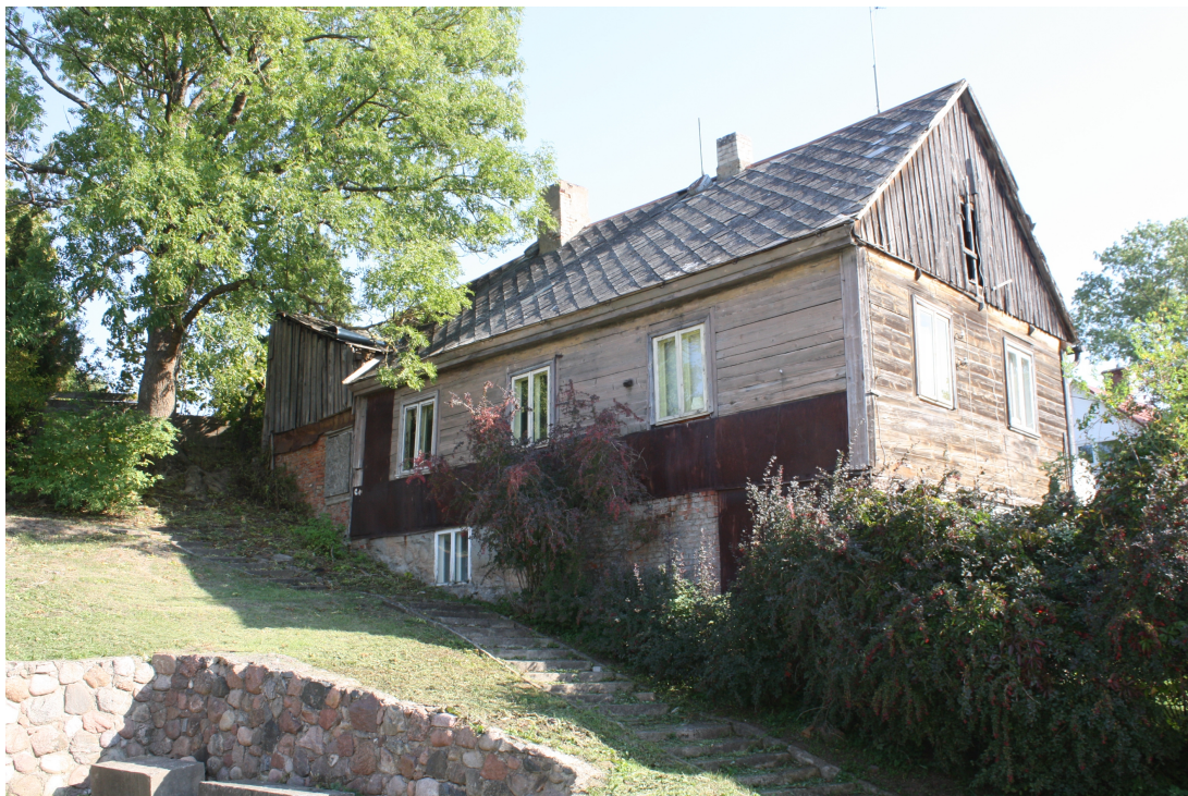
Liela_32A_88010120191002_fasade5 Skats uz ēku no dienvidrietumiem. Fasādei sekundāri labojumi ar skārda loksnēm.
