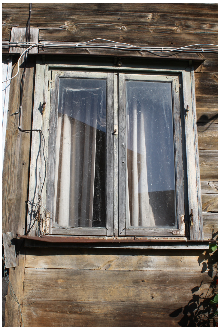
Liela_32A_88010120191002_logs1 Sākotnēja loga aploda, vērtne mainīta. Atkārtoti izmantots sākotnējais aprīkojums. Saglabājušās sākotnējās apmales un slēgu kāšu viras.
