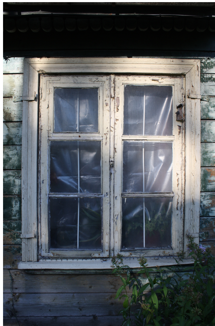
Liela_10_88010090137001_logs1 Sākotnējais logs (19.gs.3.cet.) ar atkārtoti izmantotu 18.gs. (rokoko) aprīkojumu vērtņēm. Slēgi zuduši.
