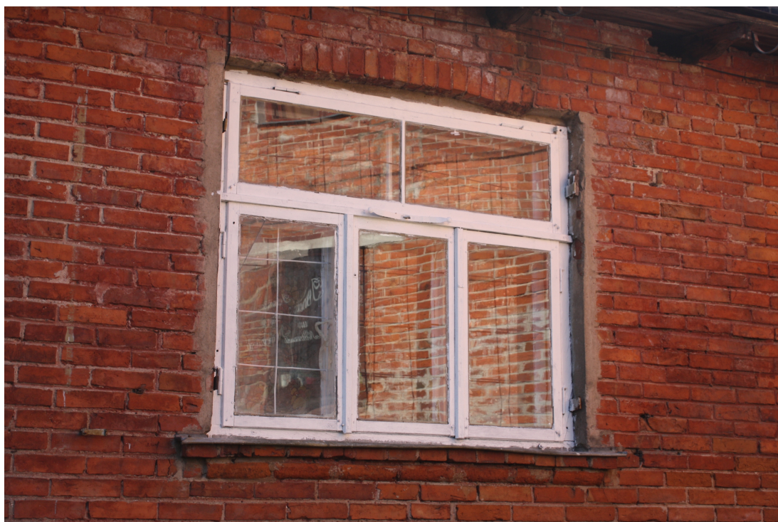
Lielaa_8A_88010090186002_logs3 20.gs.2.cet. logs piebūvē. Sākotnējā logaila paplašināta. Zuduši slēgi.
