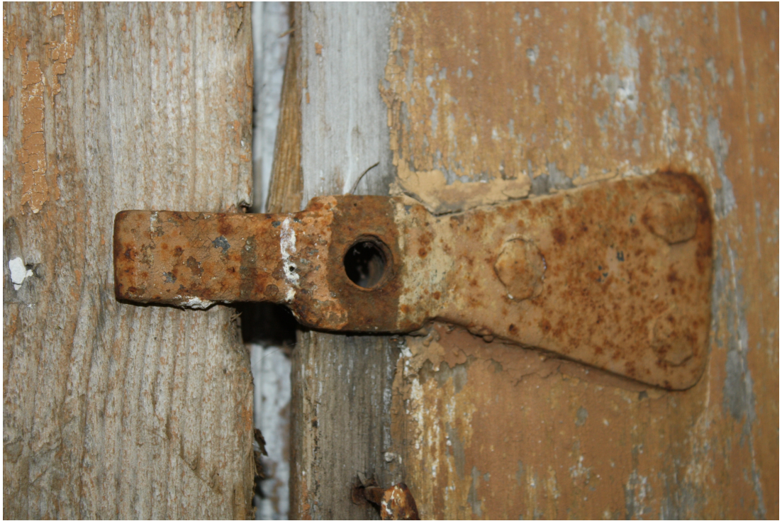
Kaleeju_2_88010130122001_slegis2 Sākotnējs aizvērta slēģa fiksators.
