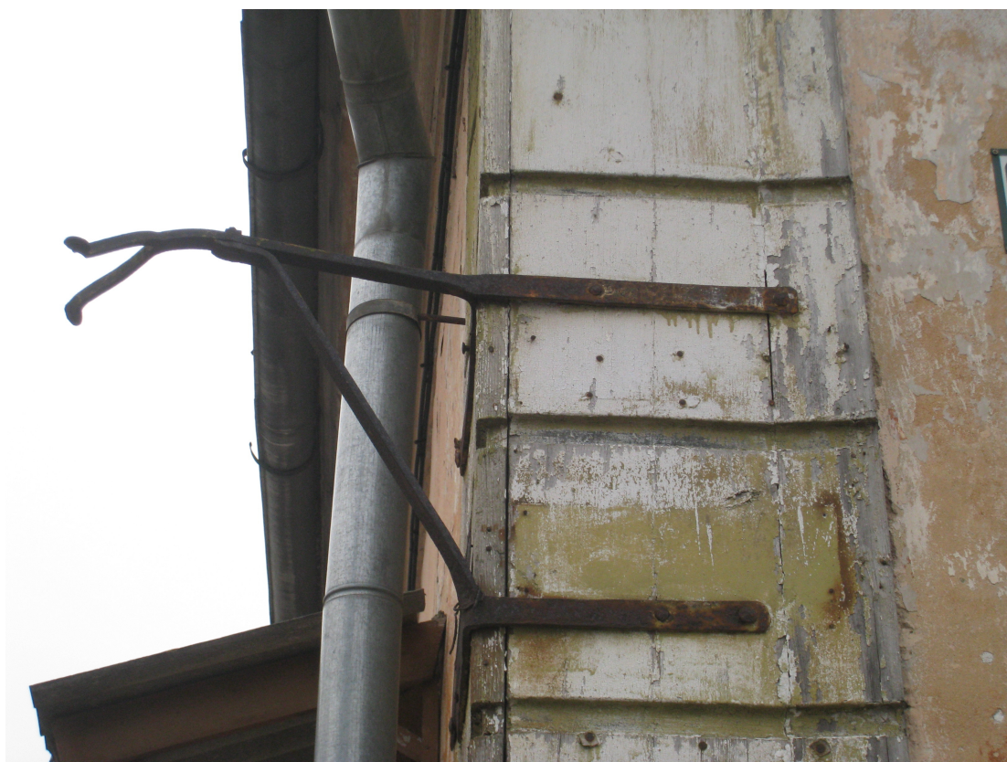
Bazniīcas_lauk_1_88010120193001_detala2 Sākotnējā lizēna ar rustojumu. Vēsturisks stiprinājums reklāmai.
